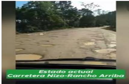
Estado actual de la carretera Nizo-Rancho Arriba, provincia San José de Ocoa.
