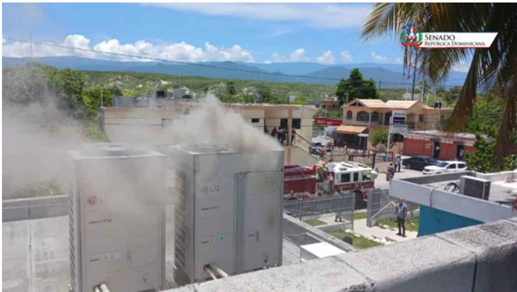
Equipos de aires acondicionados del Hospital General Melenciano, Jimaní, provincia Independencia.
