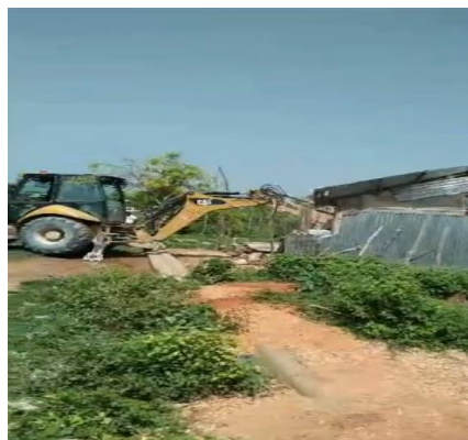
Desalojos y destrucción de viviendas en el distrito municipal, Juancho, provincia Pedernales
